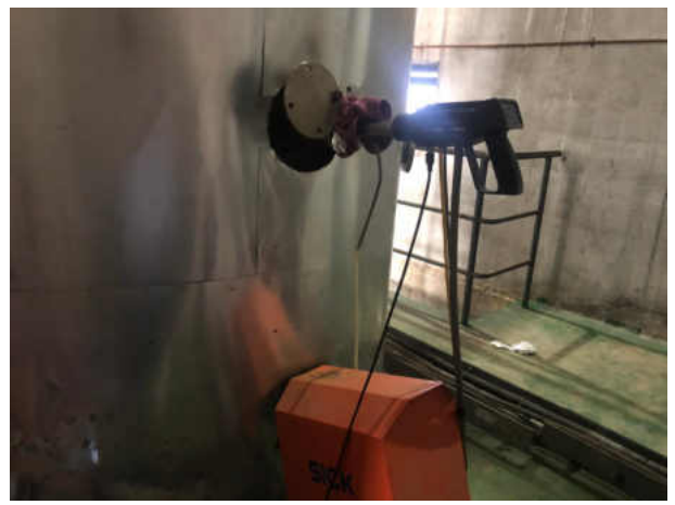
1#排气筒 DA001（◎1）有组织排放废气
