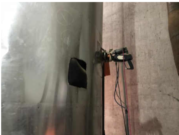
2#排气筒 DA002（◎2）有组织排放废气
